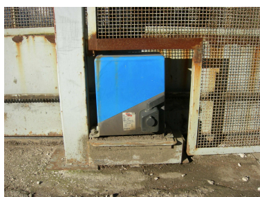
Fig. 1 – Cancelli automatico su via Laviano – Motore con sblocco manuale
