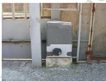
Fig. 2 – Cancelli automatico su via S. Augusto – Motore con sblocco manuale
